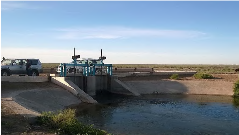
Водовыпуск-водосброс на ПК12 «Рыбачьего водохранилища», 10м 3 /сек Год ввода в эксплуатацию 2003г. Стоимость объекта 64570,0 т.с
